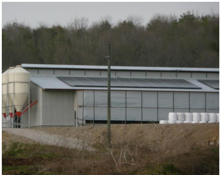
牛舎の屋根に設置された太陽光発電用パネル
