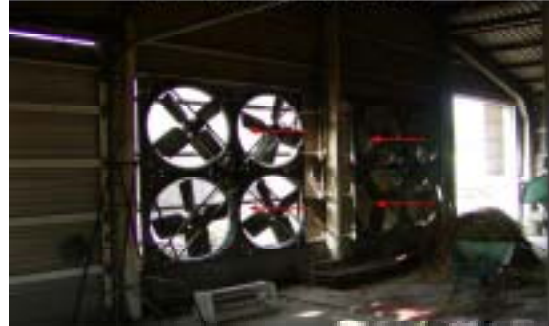
トンネル換気(内側)
